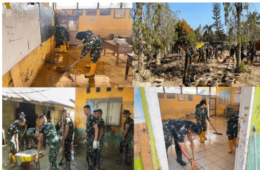
Gambar 4. Pembersihan Bekas Banjir SDN 1 Tualang Cut
